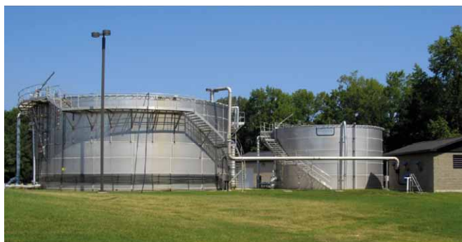
Fot. 3. Instalacja DEMON w oczyszczalni w York River (stan Waszyngton) zbiornik na odcieki (po lewej), reaktor DEMON (po prawej) [8]
