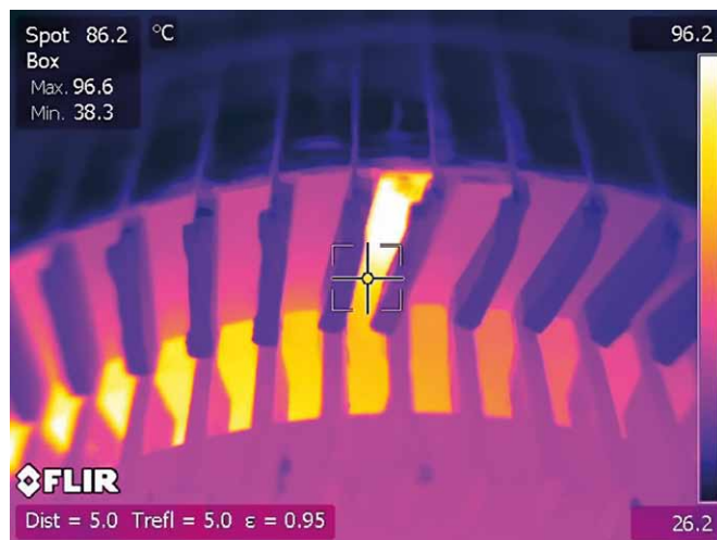
Fot. 15. Zwarcie blach żelaza czynnego przy luźnym przęcie biernym
