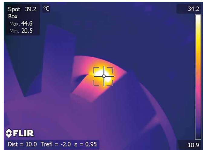
Fot. 21. Wirnik głęboko żłobkowy silnika o mocy 6,3 MW – termogram; miejsce mocowania wału wirnika
