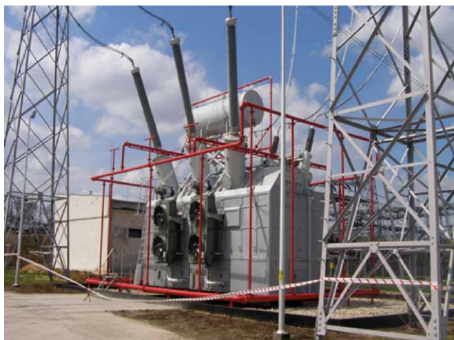
Rys. 9. Transformator o parametrach znamionowych 250 MVA, 400 kV z izolatorami suchymi typu RIP
