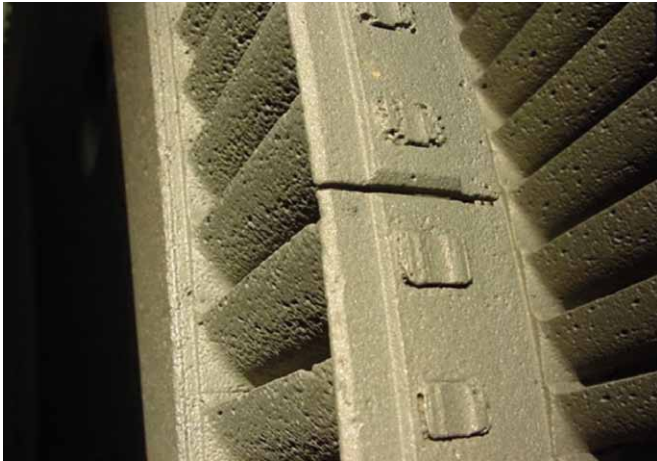
Rys. 2. Erozja powierzchni łopatek turbiny (Fot. zbiory prywatne autora)
