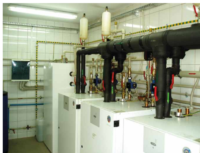
Fot. 1. OŚ Komorowice – instalacja pomp ciepła
