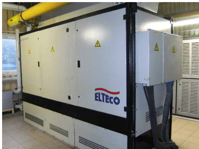
Fot. 2. OŚ Komorowice – agregat kogeneracyjny PETRA-230SCF o mocy eksploatacyjnej 170 kW
