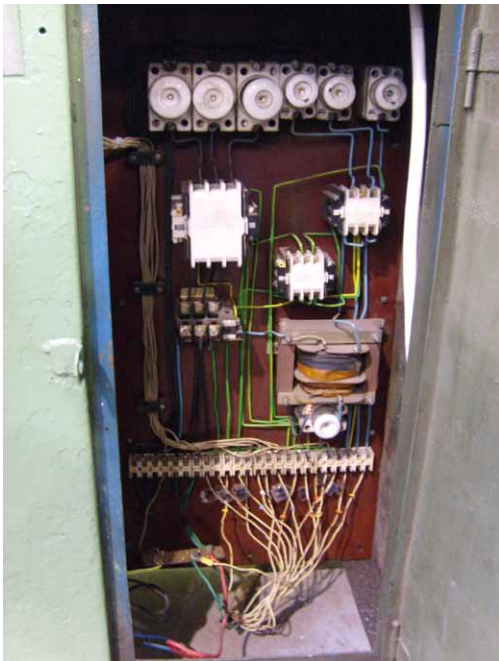
Fot. 6. Prasa PMS 100 – widok wyposażenia elektrycznego
