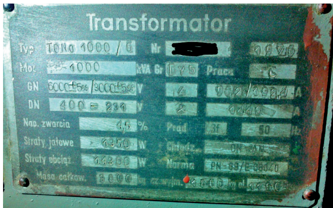
Rys. 1. Tabliczka znamionowa transformatora
