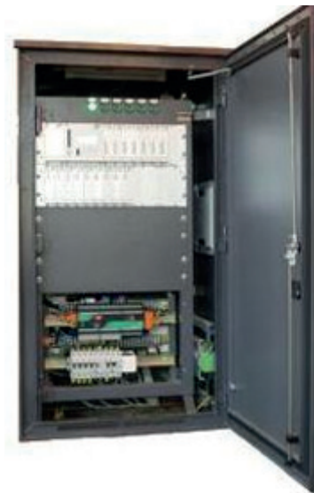
Rys. 5. System elektrycznego ogrzewania rozjazdów.
