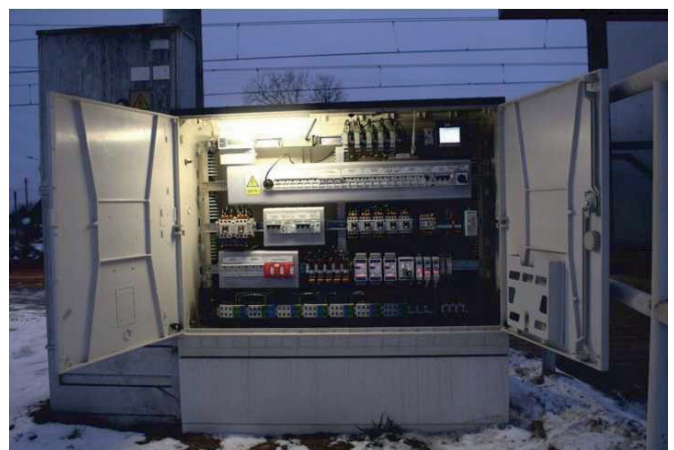
Rys. 10. Widok wnętrza szafy rozdzielczej sterowania oświetleniem terenów kolejowych typu LMP-RESO3F-10-3L3N.
