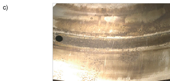
Rys. 2.141. Przykładowy wynik pomiaru stanu łożyska 22244 w cementowni wykonany przez system nadzoru stanu technicznego (a), (b) oraz uszkodzone łożysko (c)
