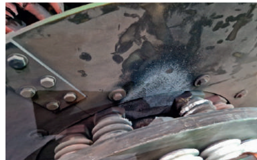
Rys. 7. Widok części głowicy silnika pierścieniowego objętej działaniem łuku elektrycznego, w wyniku czego uszkodzeniu uległy izolatory porcelanowe oraz tarcza złożona z dwóch półpierścieni [opr. wł.]
