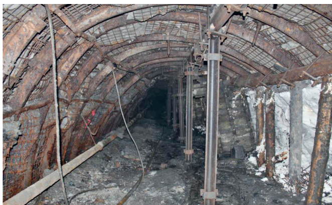
Rys. 12. Widok konwergencji chodnika 341-badawczego
