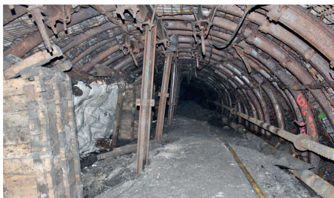
Rys. 14. Widok konwergencji chodnika 341-badawczego
