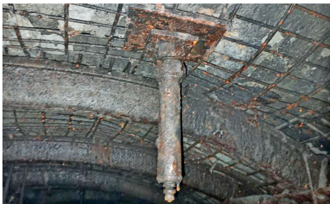
Rys. 10. Kotwa strunowa iniekcyjna zabudowana poprzez podkładkę stalową w chodniku 341-badawczym
