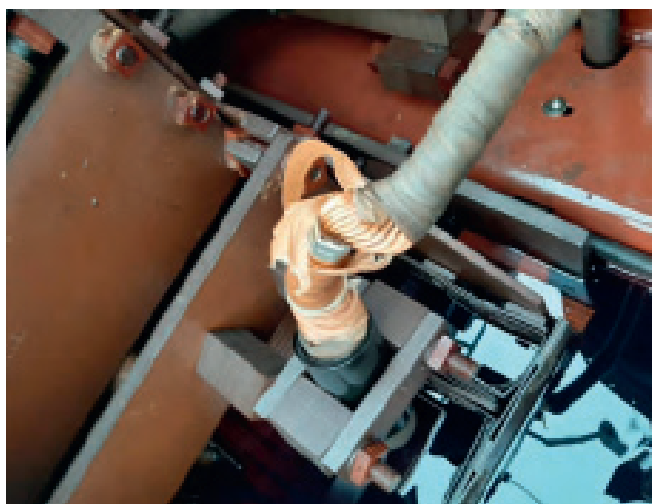
Rys. 4b. Defekt ujawniony podczas rewizji
