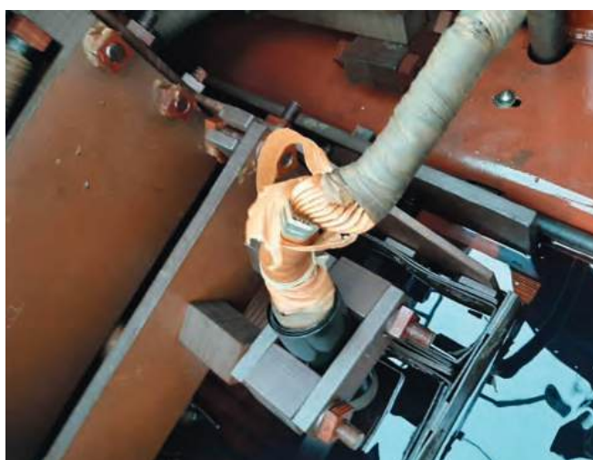
Rys. 4b. Defekt ujawniony podczas rewizji
