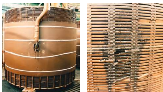
Rys. 8. Uzwojenie GN transformatora o parametrach znamionowych S_N = 270 \text{ MVA} ; U_{1N} = 15,7 \text{ kV} ; U_{2N} = 250 \text{ kV} : a) faza A nieuszkodzona, b) faza B uszkodzona
