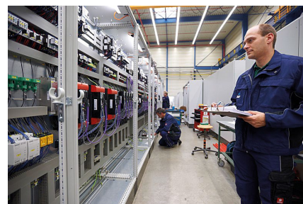
Elektryczne urządzenia rozdzielcze i sterownicze chronią ludzi znajdujących się w pobliżu przed zagrożeniami związanymi z prądem elektrycznym
