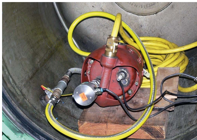
Rys. 17. Agregat pompowy w komorze zabezpieczającej przed ewentualnymi skutkami wywołanego w jego silniku wybuchu gazu w ramach badań ATEX wg normy PN-EN 60079-0:2009
