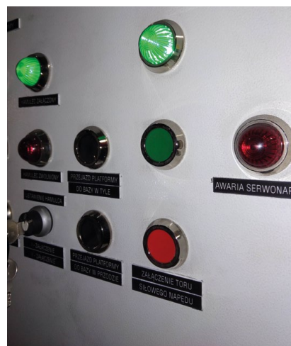
Fot. 9. Szafa sterownicza maszyny
