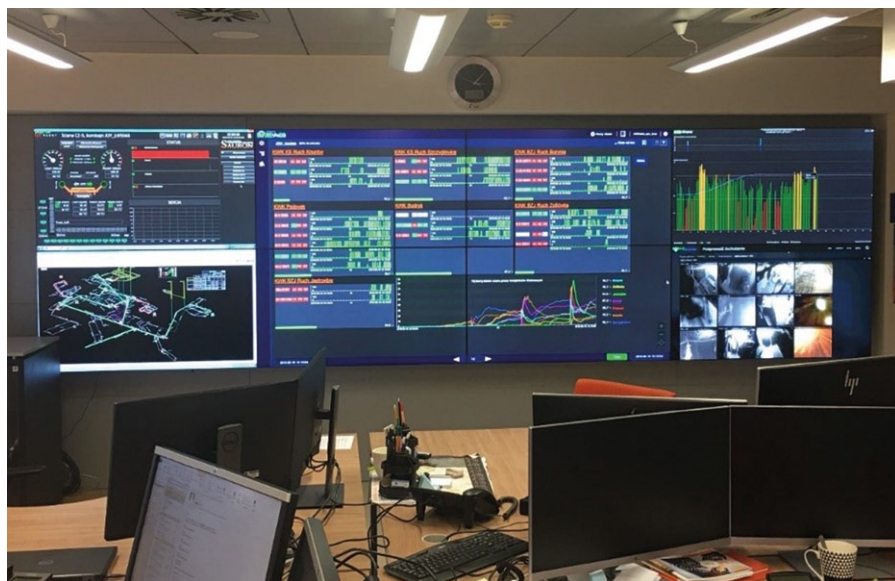
Rys. 1. Pomieszczenie Centrum Zaawansowanej Analityki Danych
