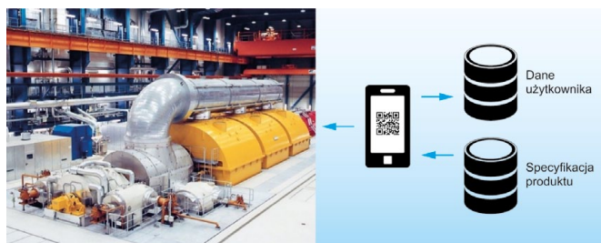
Rys. 3. Przykładowy zespół maszynowy – turbogenerator i jego otoczenie
