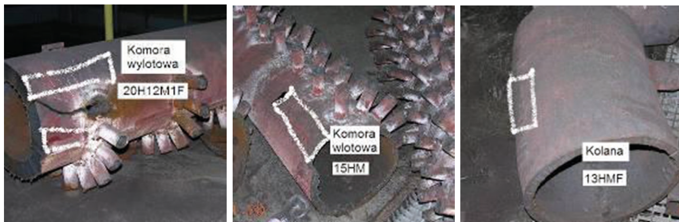
Rys. 7. Fragmenty instalacji energetycznych z zaznaczonymi miejscami pobrania materiału do badań
