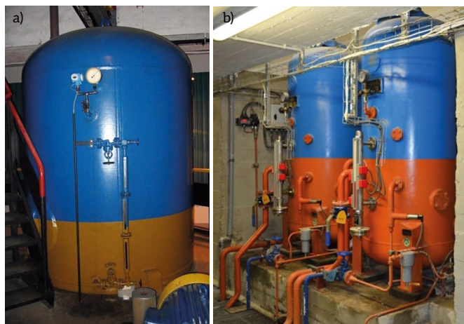
Rys. 1. Akumulator hydrauliczny zainstalowany w układzie zasilania olejowego: a) regulatora obrotów turbiny; b) przepustnicy (zaworu motylowego)
