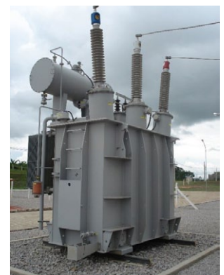
Rys. 5. Dławik 145 kV, 11,4 MVA, który pracował w Brazylii jako jednostka swobodnie oddychająca przez ponad 7 lat
