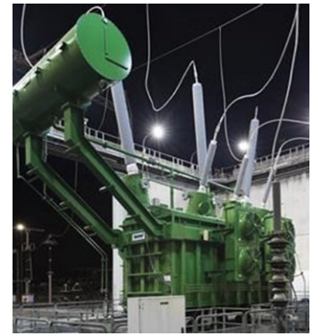
Rys. 7. Fotografia autotransformatora 420 kV, 250 MVA / 375 MVA napełnionego płynem FR3 i zainstalowanego w systemie elektroenergetycznym sieci przesyłowych we Włoszech
