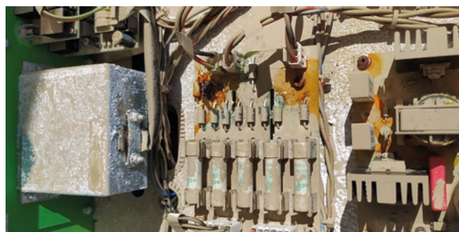
Fot. 1. Przykładowy widok wnętrza zasilacza po zalaniu
