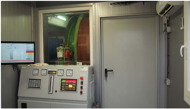
Klimatyzowane stanowisko sterownicze
