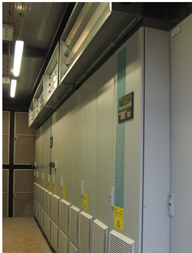
Przełączniki częstotliwości z układem czepni i wyrzutni wentylacyjnych
