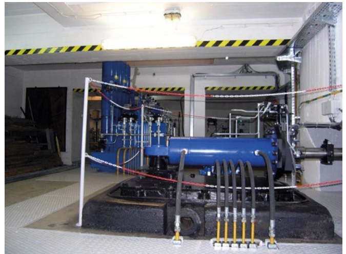
Rys. 10. Elektrohydrauliczny układ sterowania turbiną Kaplana w EW Dąbie wykonany przez Instytut Energetyki Oddział Gdańsk
