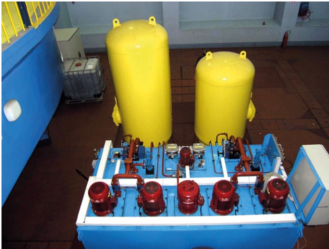
Rys. 3. EW Dębe. Zasilacz olejowy przystosowany do niezależnego zasilania aparatu kierowniczego i wirnika turbiny
