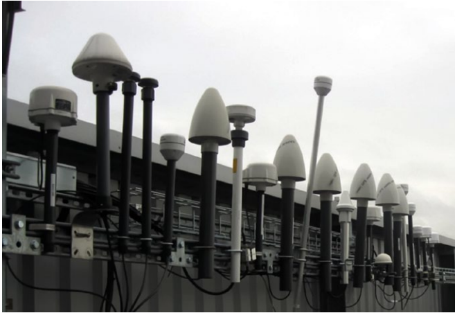
Rys. 26. Przykład wadliwej instalacji: odbiornniki zamontowane zbyt blisko siebie zakłócają się wzajemnie i dołączone są do instalacji odgromowych
