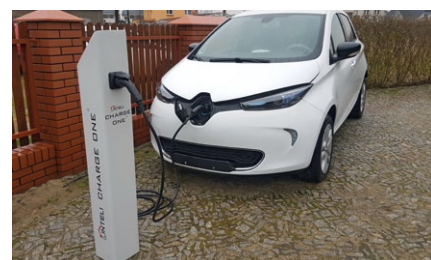
Str. 39 LINTELI Charge One. Stacja ładowania samochodów elektrycznych
