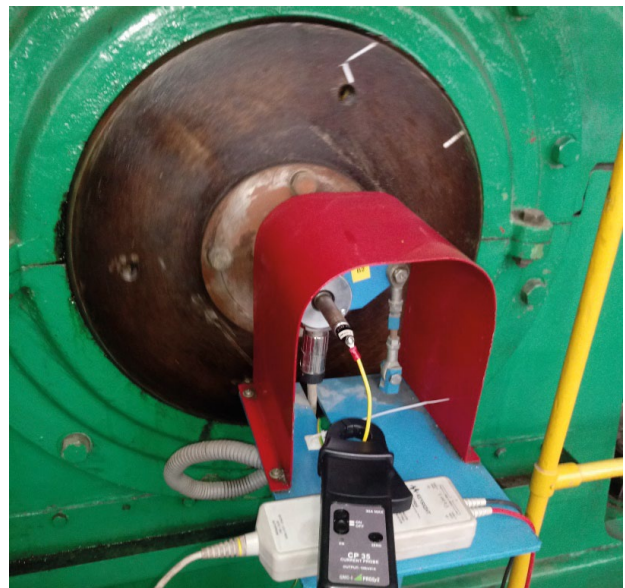
Rys. 6. Pomiar prądu poprzez złącze obrotowe
