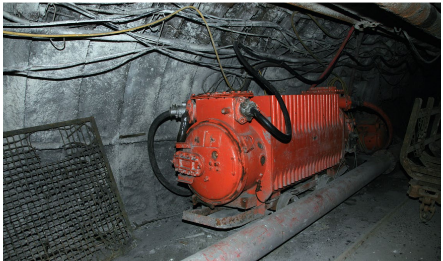
Ognioszczelna stacja transformatorowa IT3Sb 6 kV na 500 V
