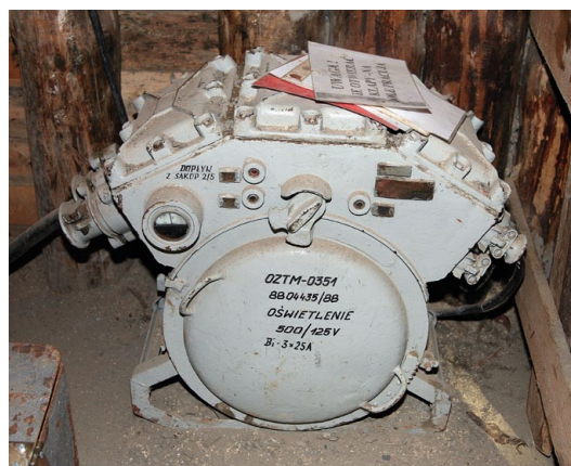
Ognioszczelny zespół transformatorowy
