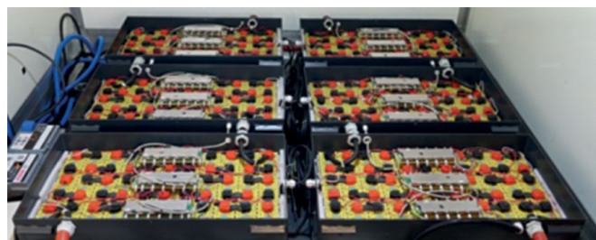
Rys. 5. Magazyn energii BAT-201
