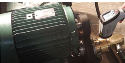
Rys. 10. Pomiar temperatury na korpusie zaworu [5]
