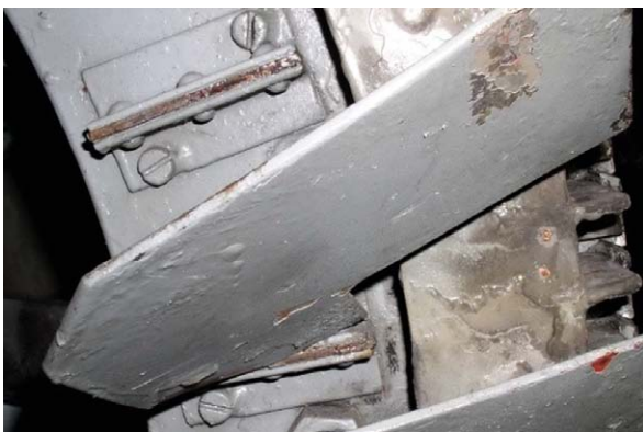
Rys. 3. Zerwanie łopatki wentylatora przymocowanego do korpusu wirnika [2, 3]
