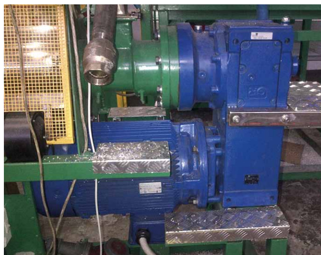
Rys. 2. Motoreduktor w wykonaniu wydłużonym zastosowany w układzie plastyfikującym
