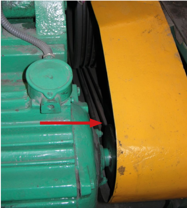
Rys. 1. Miejsce pochwycenia dłoni uszkodzone przez elementy napędowe gilotyny
