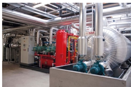
Centrum sterowania energią na giełdzie owocowej w Mittelbaden w Niemczech. Przy aktywnym wsparciu ze strony B&R firma aeteba rozwinęła modułowe i skalowalne rozwiązanie sterowania, które sprzęga wszystkie układy zasilania (Źródło: aeteba GmbH)
