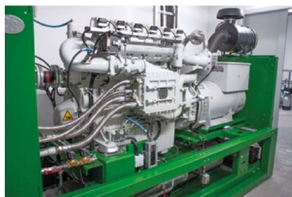
W samym centrum nowego układu zasilania energią, zaprojektowanego i wdrożonego przez aeteba, znajduje się agregat wytwarzający ciepło i prąd, o mocy odpowiednio 200 i 256 kilowatów. Moc i ciepło resztkowe są wykorzystywane przede wszystkim do wytwarzania energii do chłodzenia (Źródło: aeteba GmbH)
