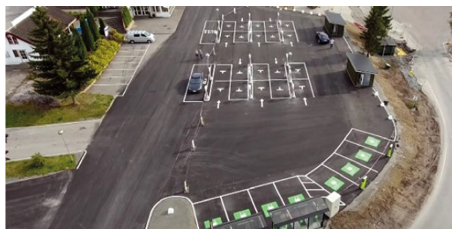
Rys. 9. Stacja szybkiego ładowania o mocy 500 kW na 28 stanowisk w Norwegii [3]
