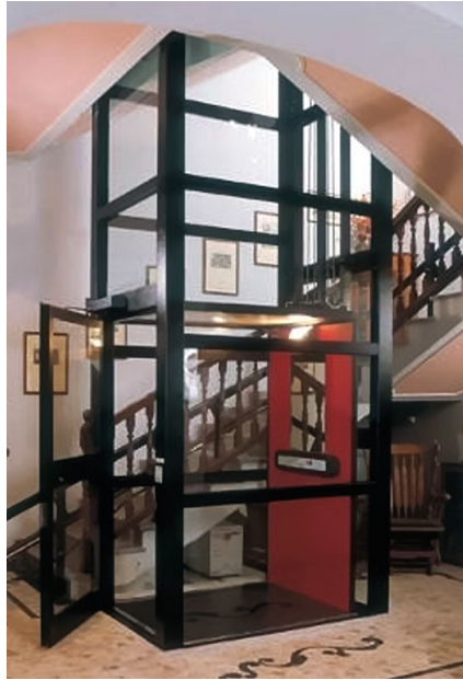
Fot. 2. Platforma do podnoszenia osób niepełnosprawnych
