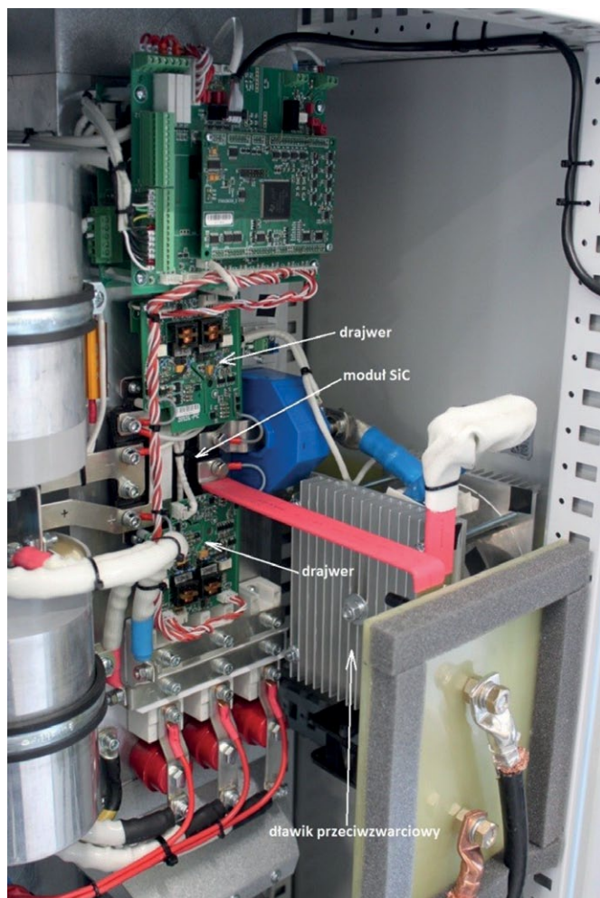
Rys. 2. Zdjęcie fragmentu stanowiska obejmujące 1-fazowy falownik wraz z elementami sterującymi i zabezpieczającymi
