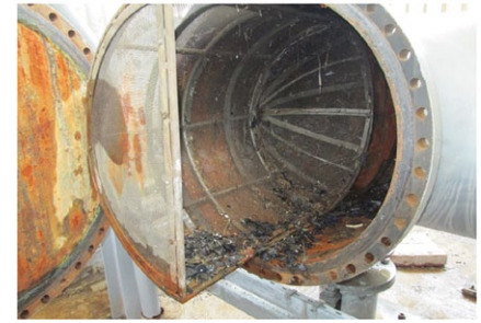
Rys. 8. Zanieczyszczenia filtra na ssaniu pompy
