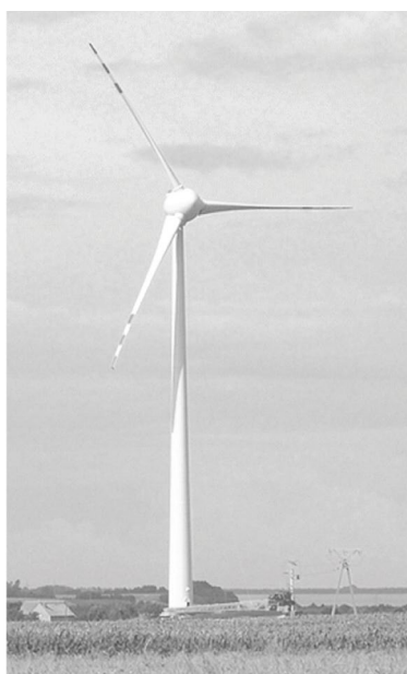
Rys. 5. Elektrownia wiatrowa w Pucku [w6]
