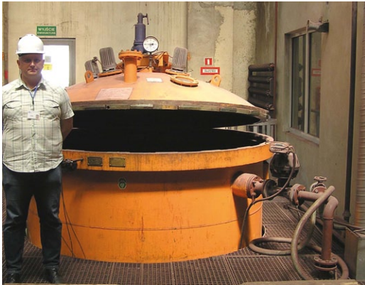
Rys. 8. Stanowisko do nasycania próżniowego elementów maszyn elektrycznych w DFME. Długość zbiornika 6 m, średnica 2,1 m
