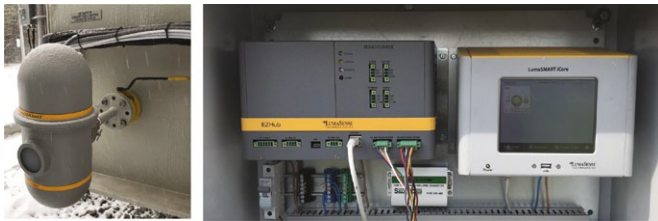
Rys. 2. Widok zamontowanego na zaworze urządzenia pomiarowego oraz interfejsów użytkownika systemu SmartDGA zamontowanych w dedykowanej szafie
