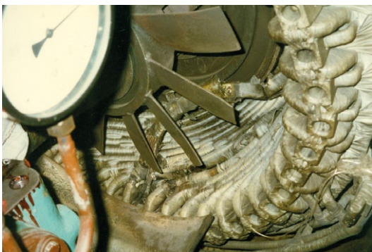
Rys. 12. Uszkodzenie czoł uzwojenia stojana przez łopatkę wentylatora
