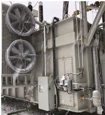
Rys. 3. Widok ogólny czujnika systemu na transformatorze energetycznym
