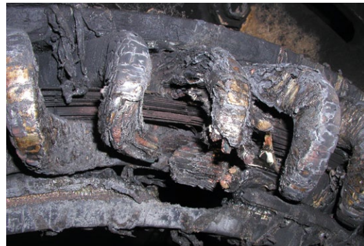
Rys. 6. Zniszczenia główek cewek
