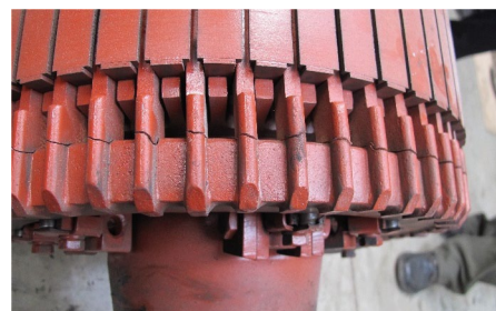
Rys. 3. Uszkodzone uzwojenie wirnika silnika trakcyjnego
