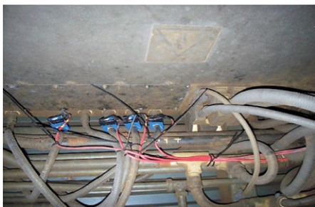
Rys. 5. Przetworniki prądu zamontowane pod pojazdem szynowym
