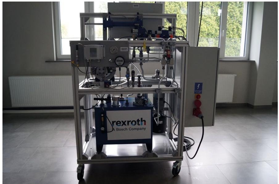
Monitorowany system hydrauliczny realizujący przykładową funkcjonalność ruchu z wykorzystaniem cylindra
