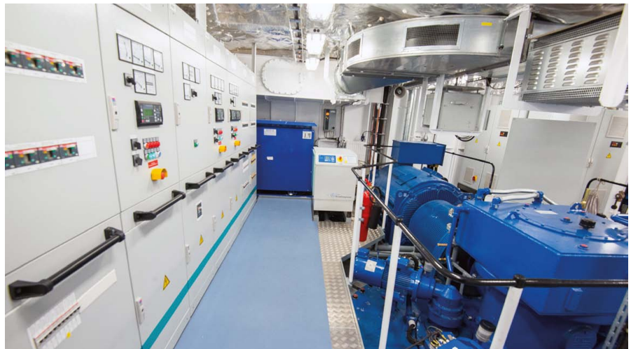
W maszynowni promu Ostfriesland wykorzystano wiele standardowych obudów sterowniczych serii AE firmy Rittal w celu zapewnienia zdecentralizowanego rozdziału systemów instalacyjnych
