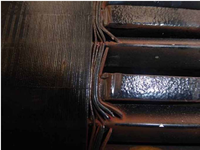
Rys. 27. Widoczne uszkodzenia pakietu przy prętach i klinach - miejsce nr 1
