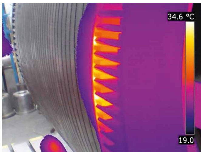
Rys. 33. Termogram nałożony na zdjęcie, widoczne zwarcia wokół prętów
