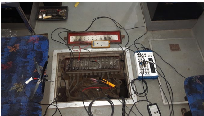
Rys. 8. Widok tabliczki zaciskowej badanego silnika z zamontowanym układem pomiarowym
