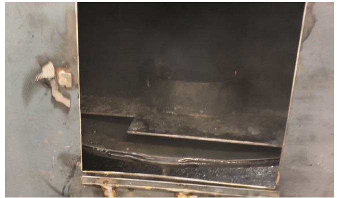
Rys. 8. Próba gaszenia materiału palnego w miejscu kołnierza bębna I/II napędu przenośnika taśmowego (moment gaszenia płomienia) [2]
