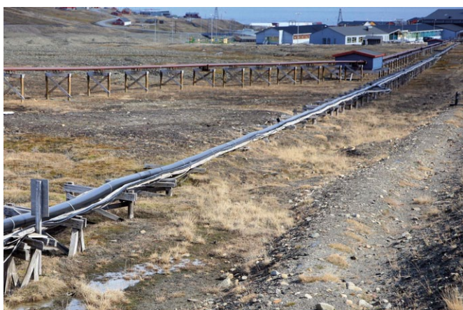
Linie kablowe prowadzone w rurach ochronnych
