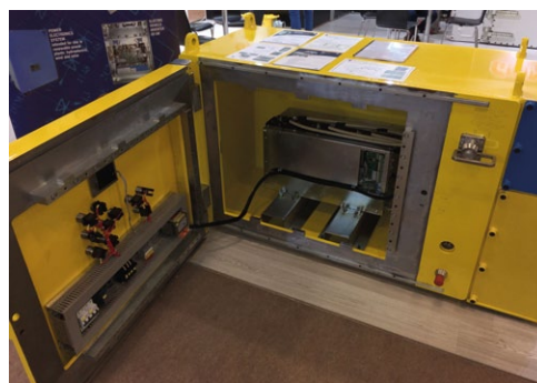
Rys. 2. Moduł przekształtnika MFC810 o mocy 250 kW zainstalowany w obudowie przeciwwybuchowej, prezentowany na Targach MINEX 2019 w Izmirze w Turcji
