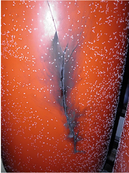
Rys. 2. Widok uszkodzonego uzwojenia fazy B uzwojenia 15 kV (fot. serwisu producenta)
