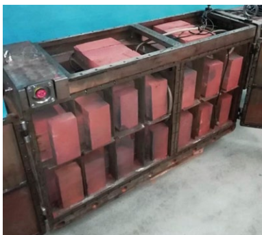
Rys. 7. Widok wypełnienia wnętrza komory skrzyni akumulatorowej [7]
