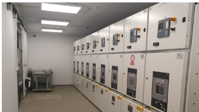
Fot. 3 – rozdzielnia 20 kV stacji GPO
