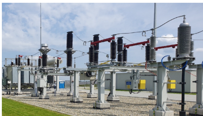
Fot. 2 – rozdzielnia 110 kV stacji GPO
