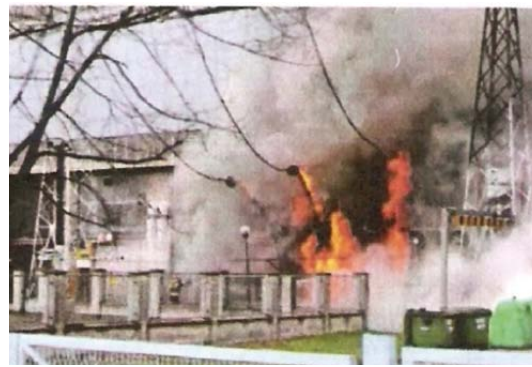
Rys. 2. Rozszczelnienie między pokrywą a kadzią wielkości około 8 cm i pożar transformatora
