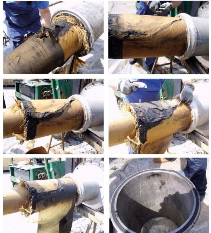
Rys. 6. Zdjęcia ilustrujące kanał przepływu prądu upływu wewnątrz izolacji papierowej rdzenia kondensatorowego (4)
