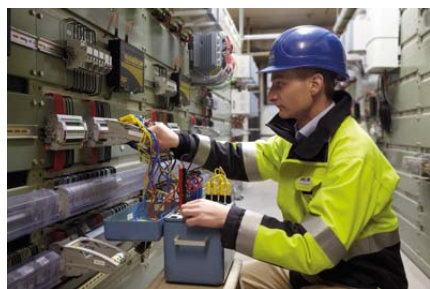
Rys. 1. Nowe możliwości dla nowoczesnych rozdzielni: Zakład Energetyczny w Monachium wykorzystuje FAME do kontroli i pomiarów
