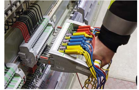
Rys. 3. Nowe możliwości w stacjach elektroenergetycznych: Zakład Energetyczny w Monachium modernizuje swoje rozdzielnie z użyciem systemu kontrolno-pomiarowego FAME firmy Phoenix Contact
