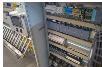
Szafa sterująca systemu transportowego
