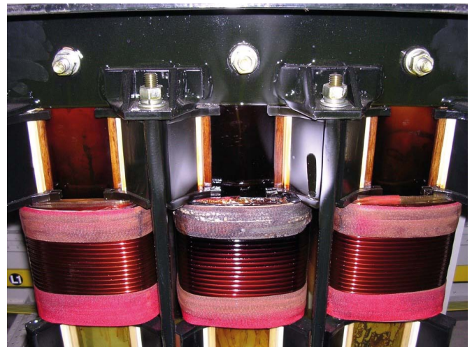
Rys. 5. Przegrzane uzwojenie i rdzeń dławika
