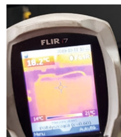
Rys. 13. Pomiar rozkładu temperatury w komorze baterii
