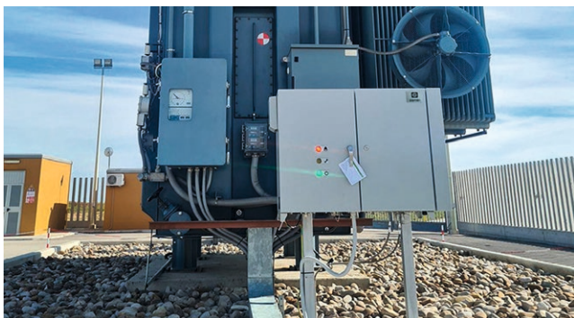
↑ Rys. 20. Zaawansowany system DGA monitorowania oleju izolacyjnego
